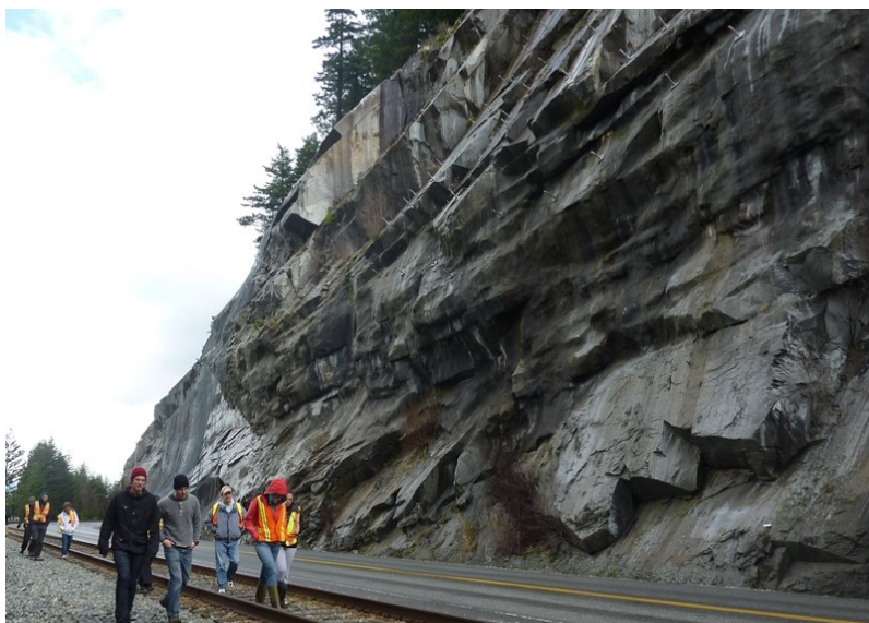
圖 1. Porteau Cove 的 2008 年岩石滑坡現場。注意平行於斜坡表面的突出裂縫。用岩石螺栓（上）穩定了斜坡，並在岩石上鑽了一些孔以改善排水（右下角可見）。懸掛網狀幕布（背景）可降低因掉落而使車輛駛過的危險。[SE 照片 2012]
