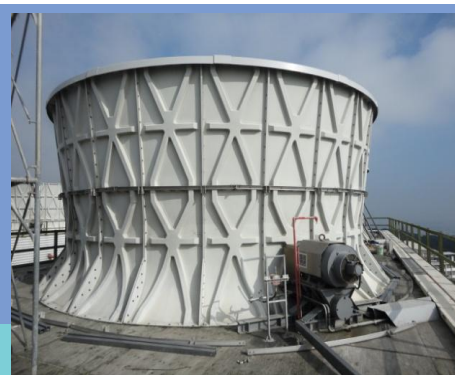
外部已有風胴 (Fan Stack)包覆
