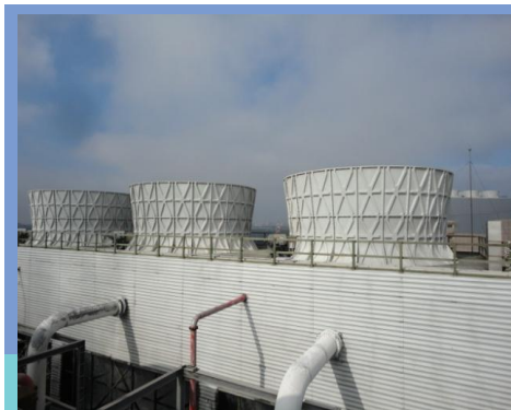
2組逆流式冷卻水塔 (每組3顆排風扇)
