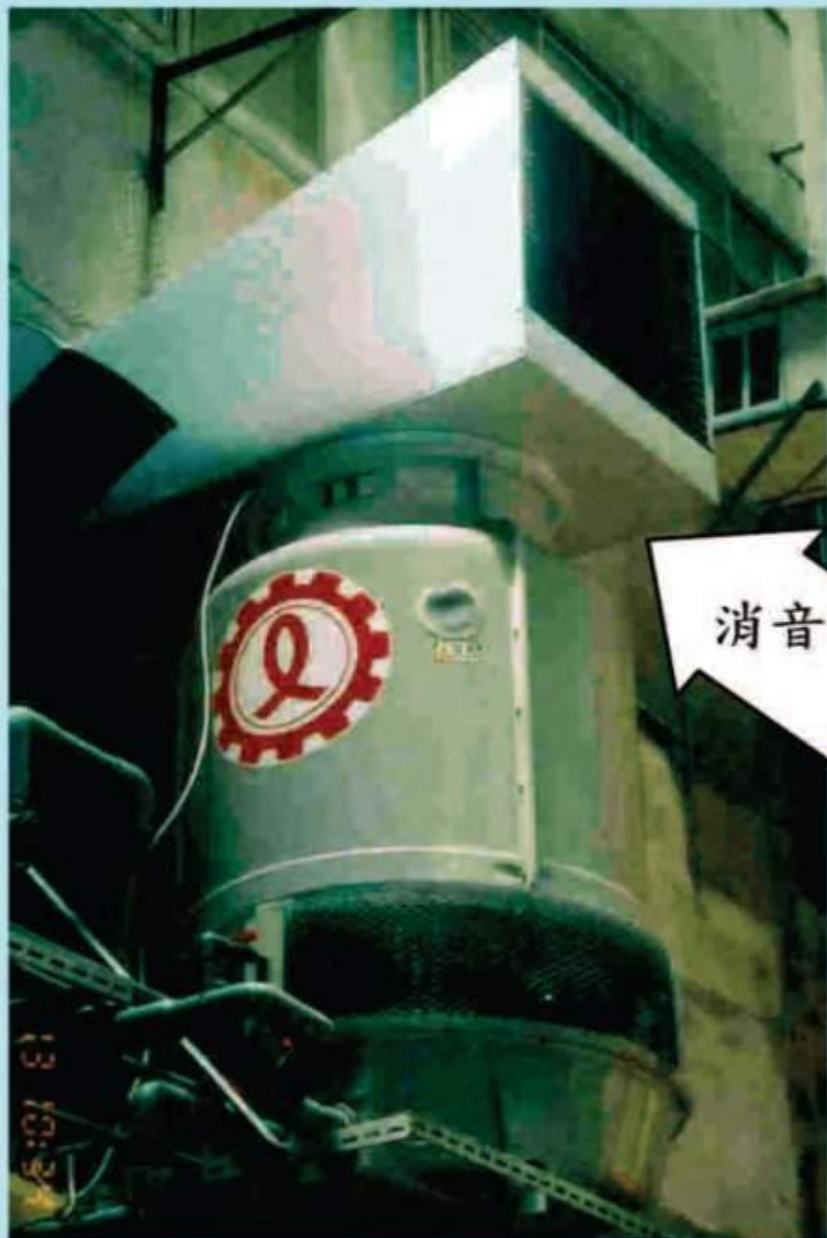
噪音源防制--案例三： 冷卻水塔加裝消音器
