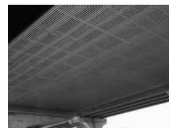
橋下吸音板 (懸吊式)
