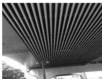
橋下吸音圓筒 (懸吊式)
